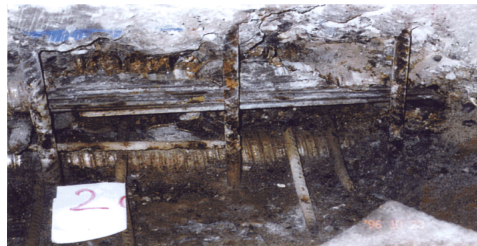
Corrosione in presenza di cloruri
